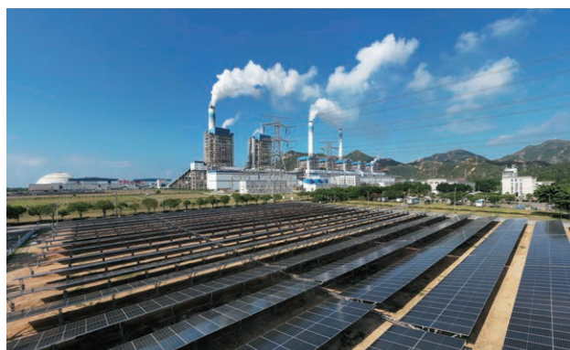
台山电力分布式光伏项目
